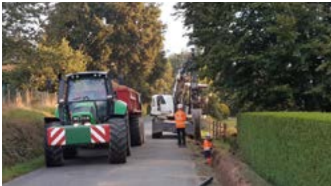
Depuis le 2 septembre et jusqu'à mi-octobre, le réseau d'eau potable de la commune déléguée de Rouellé, géré par le SDeau 50, est remis à neuf. Les canalisations sont remplacées sur une distance d'1,2 km ainsi que tous les compteurs des abonnés. L'équipement datait de 1972. La municipalité réalisera ensuite des travaux de sécurisation du bourg, en redessinant la voirie et en matérialisant des accès piétonniers. Cette deuxième tranche se terminera début décembre .
