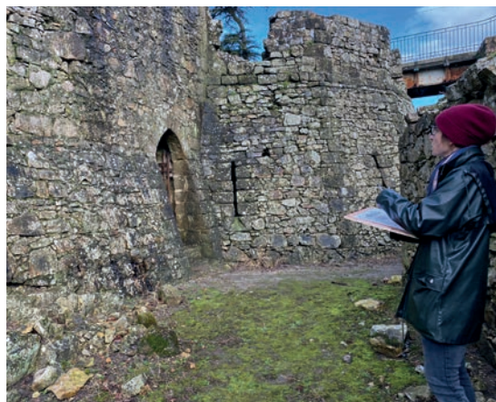
L'architecte du patrimoine Perrine Leclerc lors d'une séance de travail dans le cadre de l'étude sanitaire menée au château.
