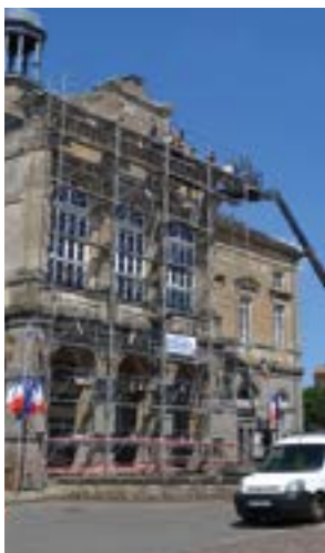
En mai dernier, un imposant échafaudage a été installé plusieurs jours devant la mairie par une entreprise de couverture. L'objectif : remettre en état une partie de la toiture en zinc, abîmée par le temps et qui menaçait de tomber.
